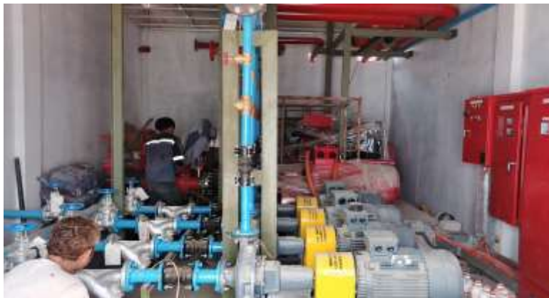
Kondisi dalam area Ruang Pompa
