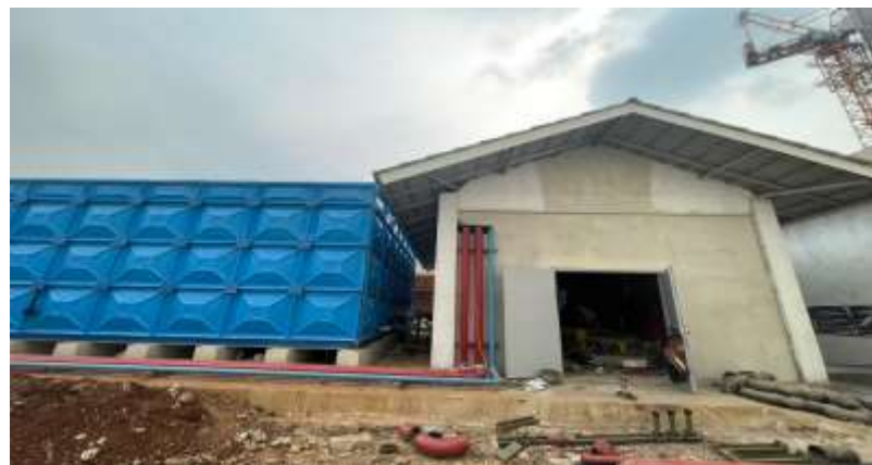
Tampak Ruang Pompa dan Water Tank
